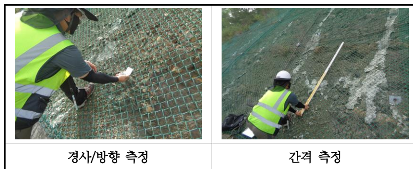
【사진 45.3.2】 불연속면 측정 현황
